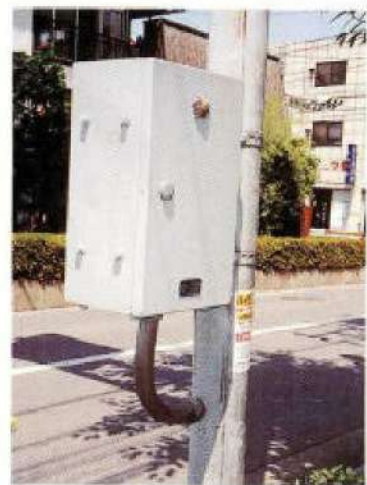
信号機の電気配管 (東京都)
