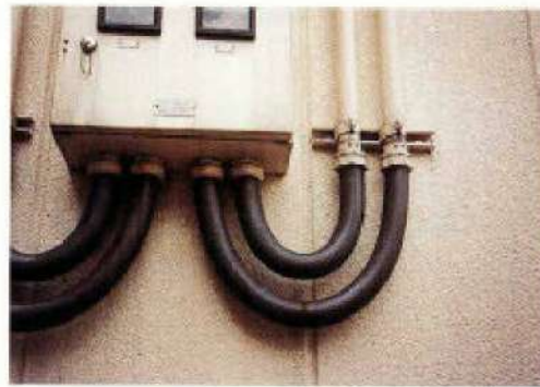
高速道路のサービスエリア電気配管 (埼玉県)
