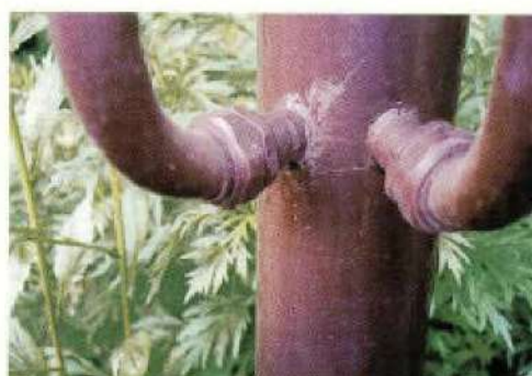
塩害地域でも錆に強い実績(千葉県)
